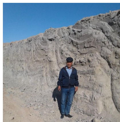
Рис. 2. Намытая упорная призма Отсечной дамбы высотой более 3 м, держащая вертикальный откос более 10 лет.
