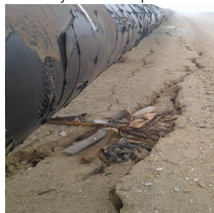
Рис. 1. Разломы в дамбах из привозного грунта под распределительным пульпопроводом на хвостохранилище 2.
